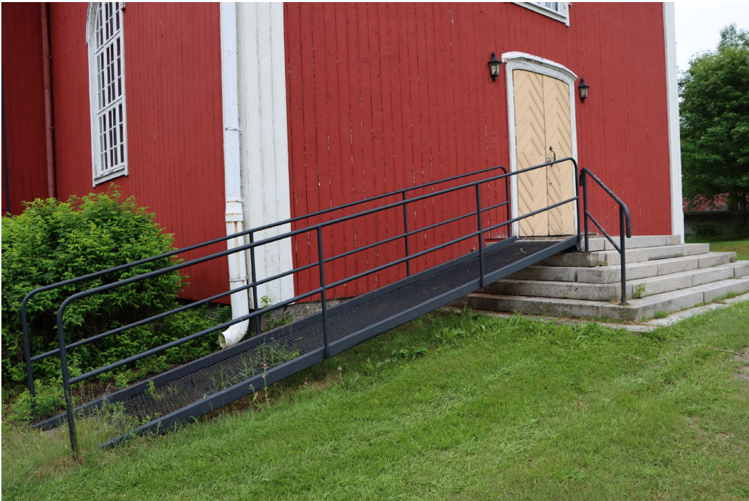
Kuva 13. Liian kalteva esteetön ramppi.
