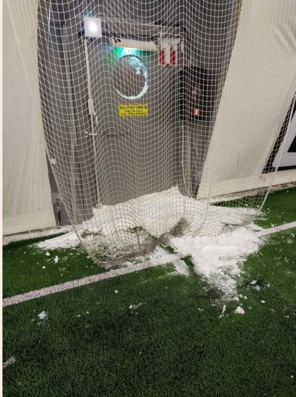
Kiinteän oviosan vaurio on syntynyt liikkuvan pressurakenteen ja kiinteän oviosan välisen sauman repeämisestä.
