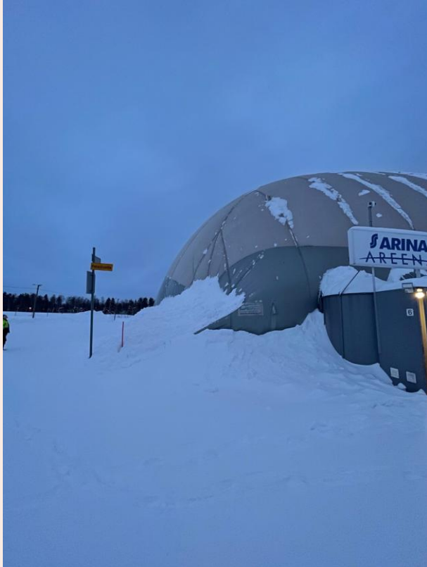
Lumenkuormituksesta aiheutunut vaurio
