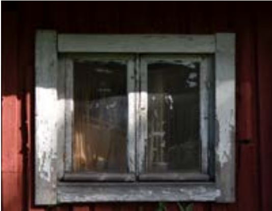
Kuva 8. Kunnostettavana oleva vanhan talousrakennuksen ikkuna. Talousrakennukset maalattiin usein punamultamaalilla ja listat ja ikkunat valkoisella maalilla.
