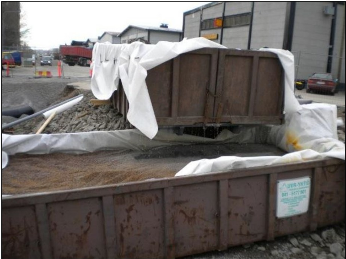
Kuva 18 Esimerkkikuva vaihtolavan sisään rakennetusta suodattimesta. 16
