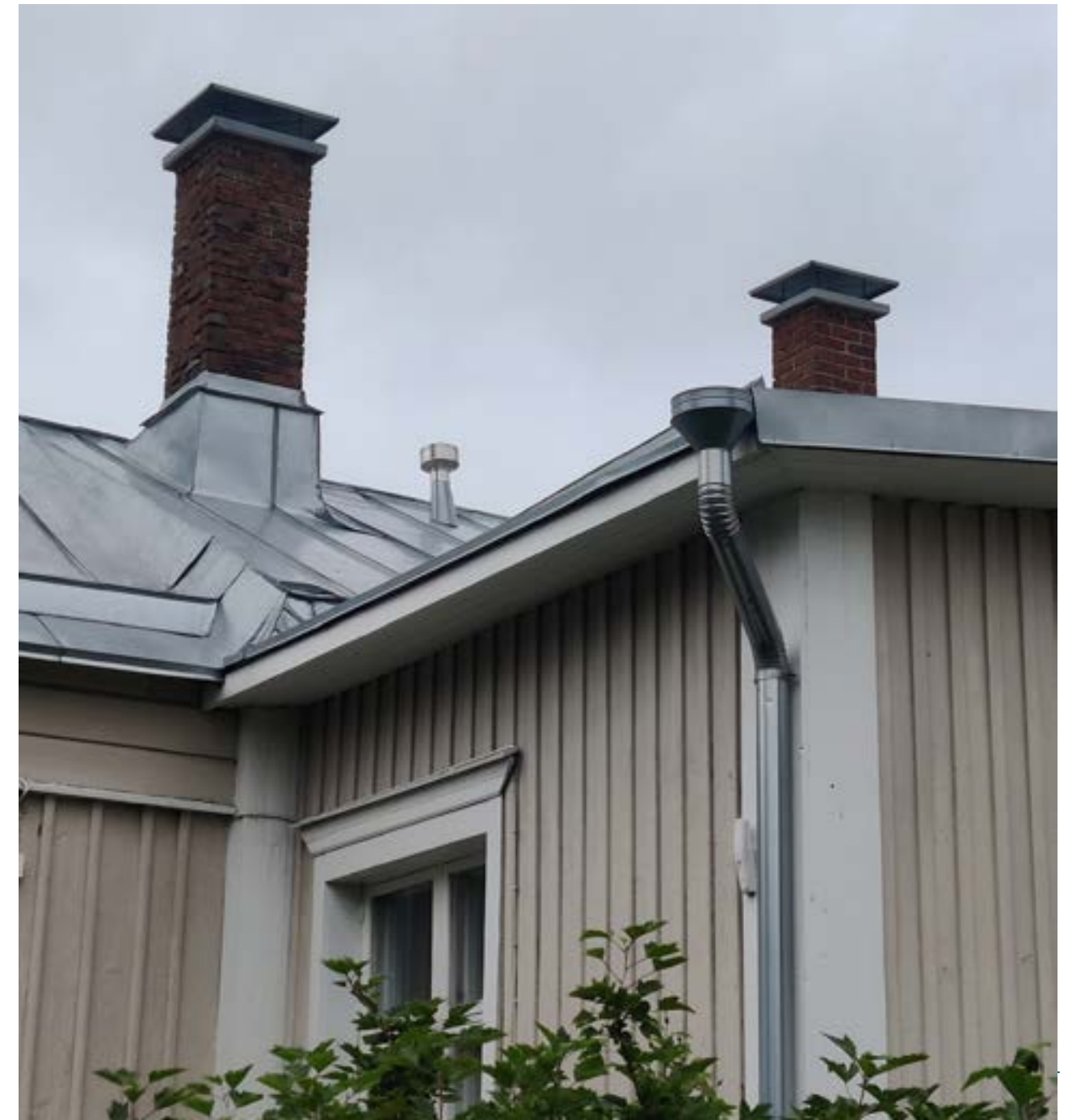
Kuva 28. Peltikatto ja tiiliset savupiiput piipunhattuineen.
