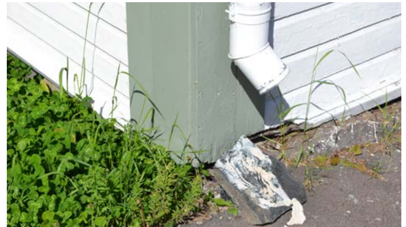
Kuva 32. Painunut kivijalka. Rakennuksen kivijalkaa ei ole juurikaan näkyvissä. Kasvisto yltää jo julkisivuverhoukseen. Painunut kivijalka estää alapohjan tuulettumisen, ja voi altistaa vaurioille.
