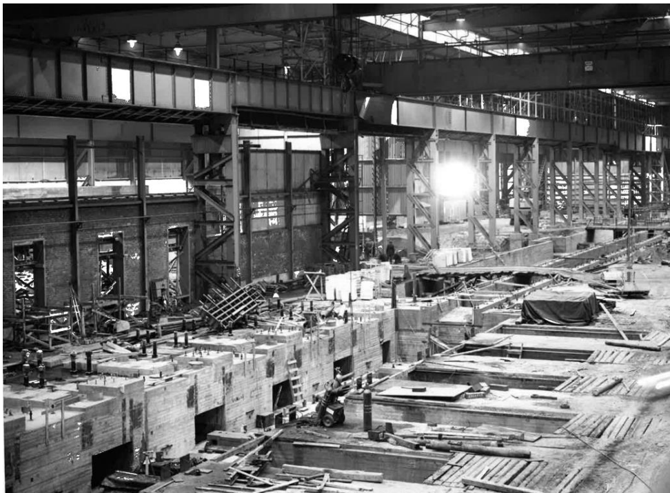
Kuva 93. Valssaamon ensimmäinen vaihe rakenteilla. Seinien alaosat on muurattu tiilestä. Alapohja on valettu betonista ja siihen on tehty
